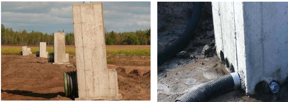
Figure 11. Structure de contrôle de nappe phréatique
